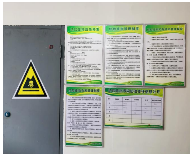
危废暂存间及危废标识
